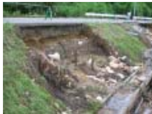
道路法面の崩壊状況
