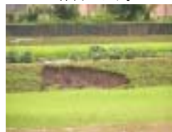
法面の崩壊状況
