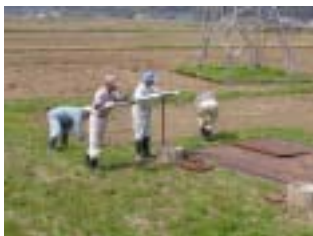
計画に基づいた配水操作の実施
