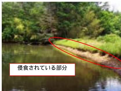
侵食が生じているため池堤体
